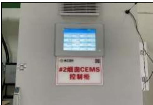
焚烧炉在线装置
