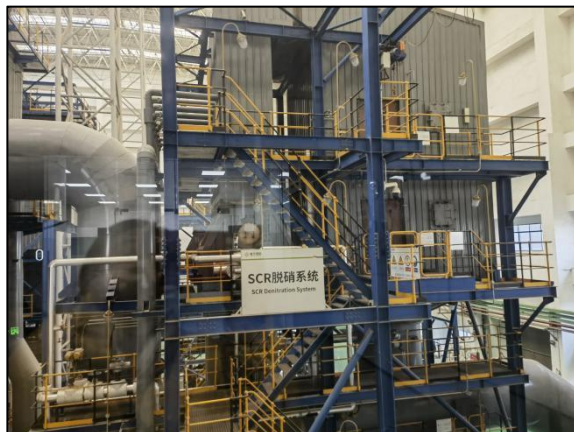
焚烧炉 SCR 装置
