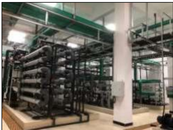
渗滤液处理站
