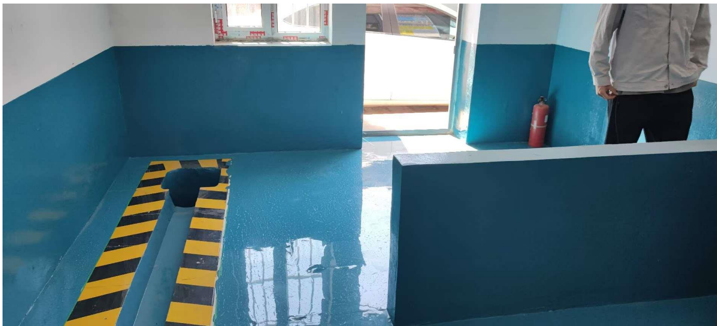
危废贮存库内部分区贮存
