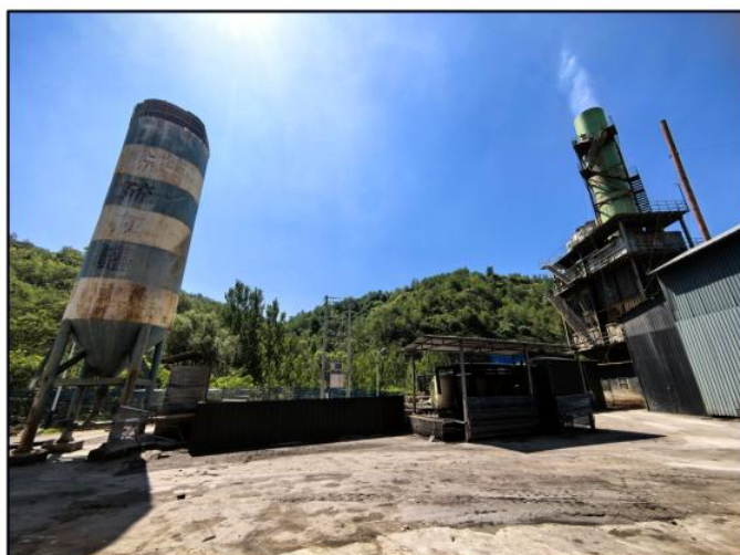
现有烟气除尘、脱硫系统（改造更新）
