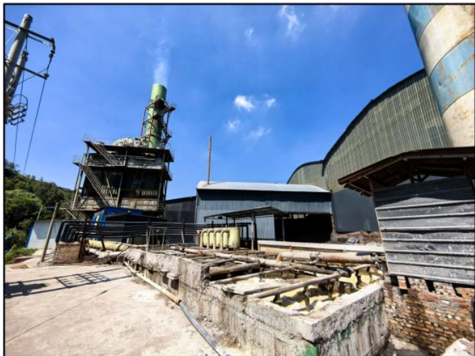
脱硫系统循环池(改造)
