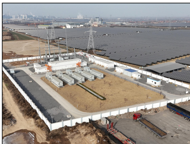
沃瑞 220kV 升压站
