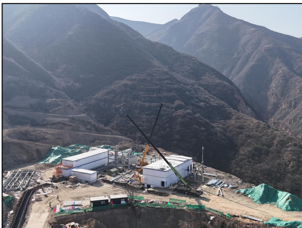
紫金山光伏 220kV 升压站处
