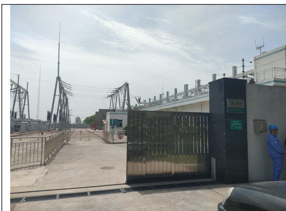
张礼 220kV 变电站
