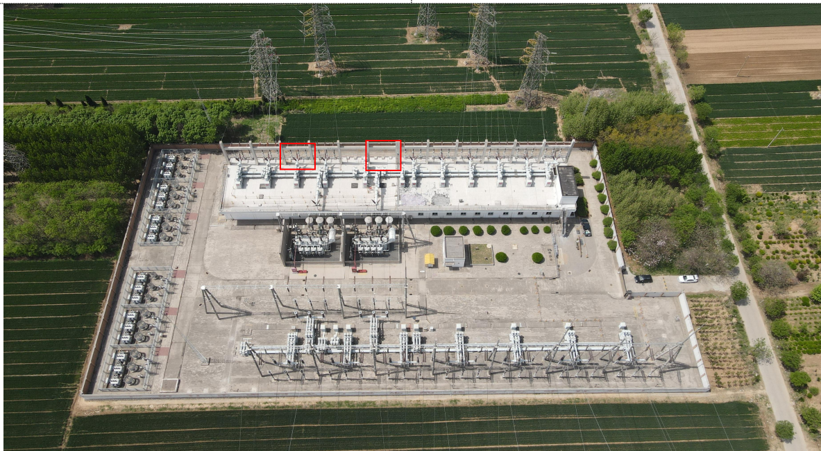
张礼变电站俯瞰图
