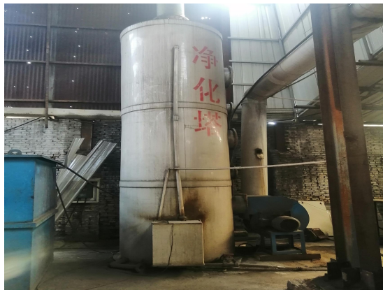
现有酸雾喷淋塔
